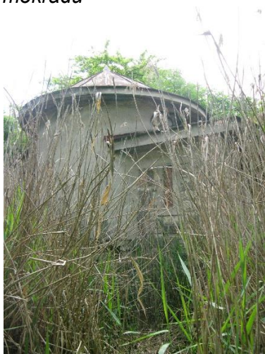
Obr. 8 Nefunkční vodárenský objekt v dolní části mokřadu
