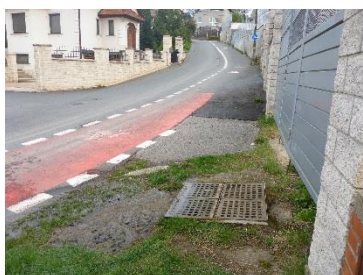
Obr. 14 Výron vody z propustku U Školky
